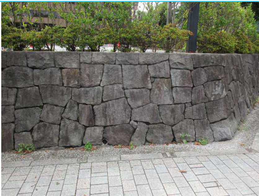
83 石積擁壁B面
